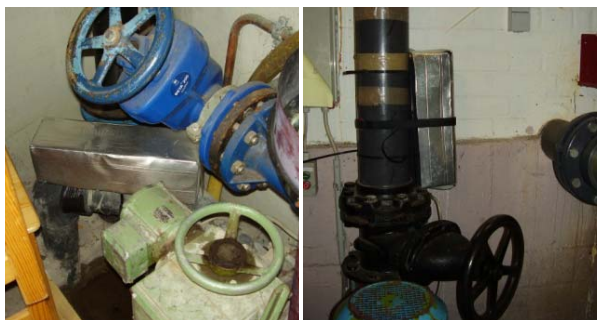
Photo 2 : Installation de la technologie memon à l'entrée de l'eau (à gauche) et au dispositif de recyclage (à droite)
